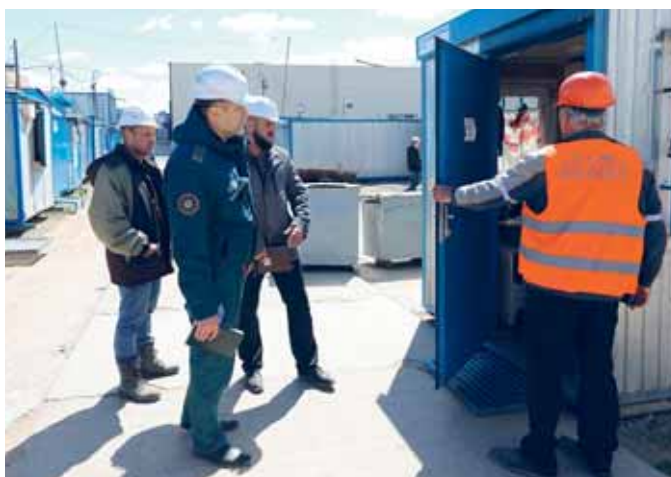
В рейде по стройплощадкам ОАО «МАПИД» участвовали: Сергей Быков, главный специалист сектора надзора и профилактики Заводского РОЧС, и Сергей Черник, ведущий инженер отдела ОТ и ТБ ГПО «Минскстрой»
